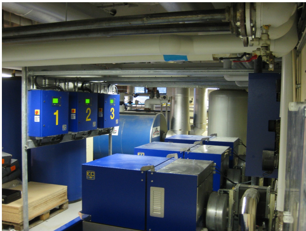
Figur 2 Eksempel på kedelcentral med mini-KV-enheder, varmepumpe og gaskedler.
